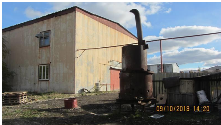
Рисунок 21. Нелегальная установка по сжиганию отходов ООО «Фабрика бытовой химии», г.Дзержинск. Фото Д. Левашова, ЭкоСПЭС.
