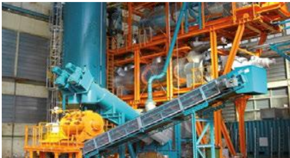
Рис. 15. Установка для вакуумной возгонки с непрямым нагревом. (Источник: ecom industries GmbH cited in UNEP/ISWA 2015)
